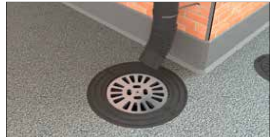
Galvanoitu sadevesikansi asennettu valurautakehykseen
